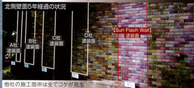
他社の施工箇所は全てコケが発生
